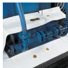
...of rond en onder machines om lekken en spatten op te vangen.
