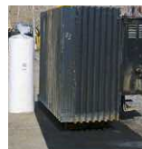
Ideaal onder lekkende transformatoren.
